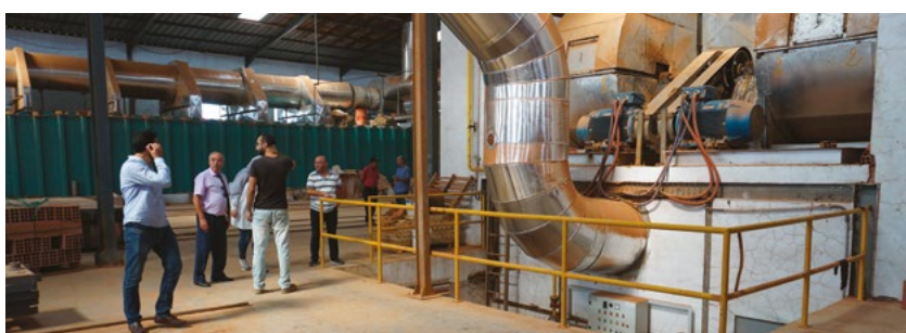
1- Réseau de récupération de chaleur du four vers le séchoir 2- Centrale de gazéification à auto-allumage installée dans le four 3- Montage d'un brûleur sur la face latérale du four
