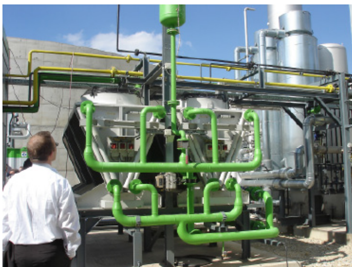
Unidad de depuración del biogás
