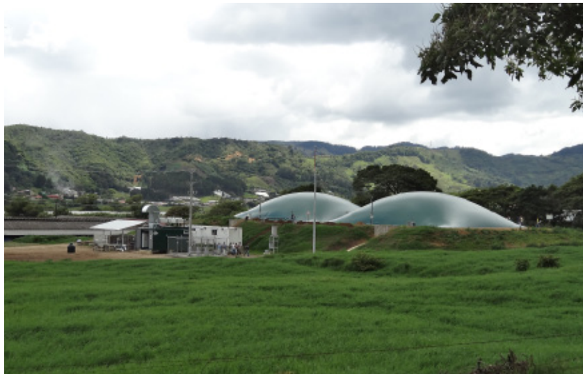
Digestor de laguna en Costa Rica
