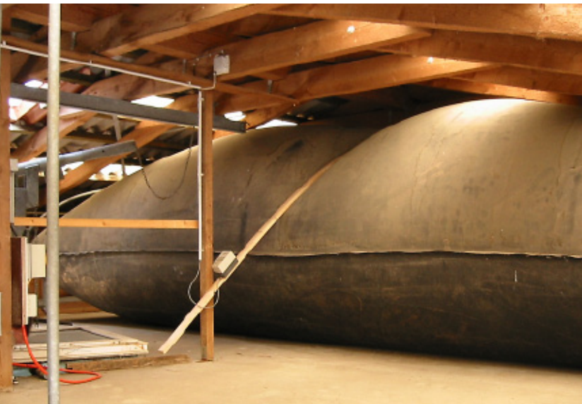
Sistema de almacenamiento de gas
