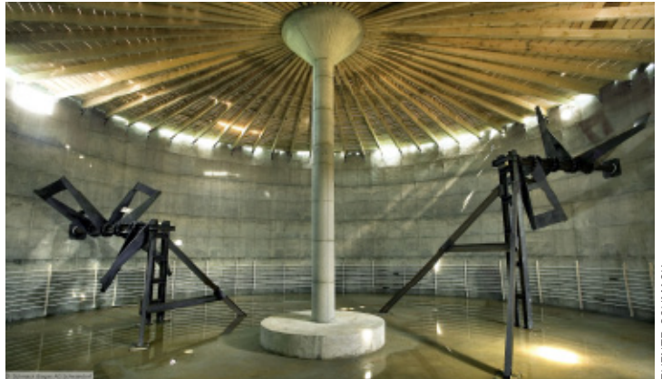
Interior de un digestor antes de la puesta en marcha
