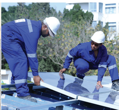
Seite 1 Pilotanlage mit einer Leistung von 19 kWp auf dem Dach des Hauptsitzes der Nationalen Energieagentur (ANME) in Tunis
