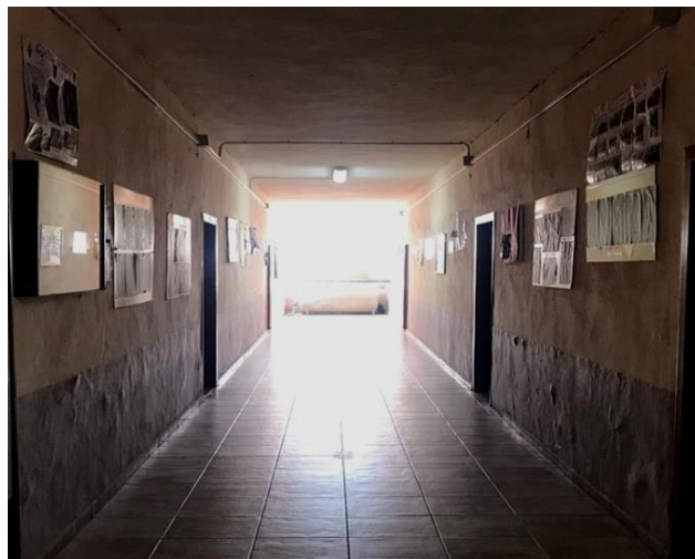
Shenja të lagështirës në muret e korridorit të katit përdhes
