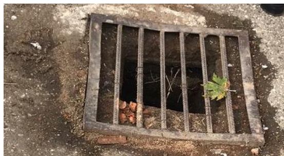
Zgara e kanalit të drenimit në oborrin e shkollës
