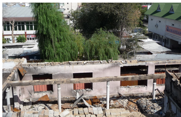
2800 Häuser wurden im Juni 2010 beschädigt oder zerstört
