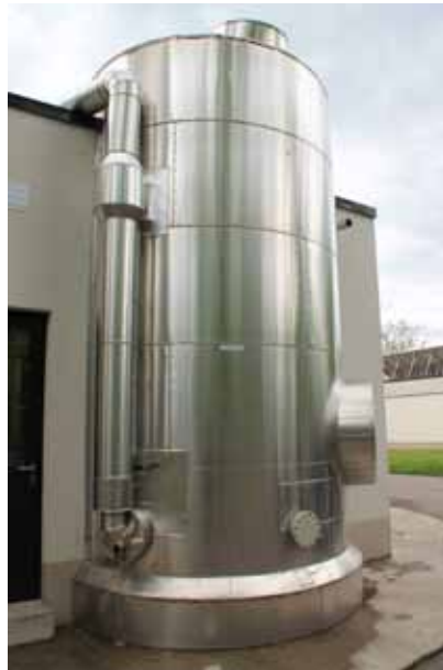
FIGURA 6.5 BIODESULFURACIÓN EN BIOPERCOLADOR - PTAR DE AUGSBURG, ALEMANIA.
