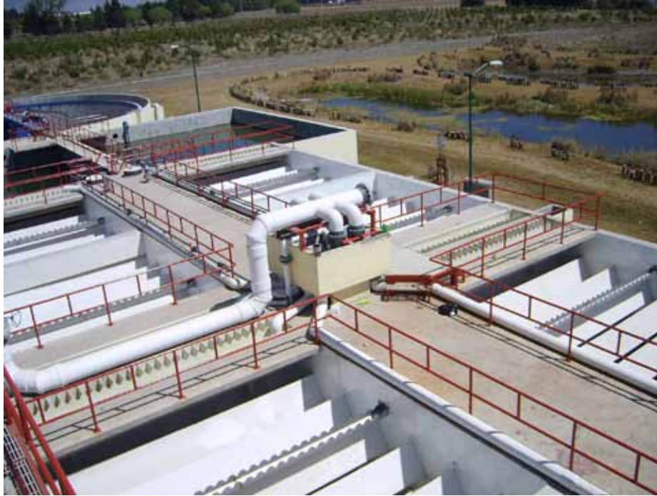
FIGURA 3.2 FOTO DEL REACTOR UASB INSTALADO EN LA PTAR DE METEPEC, ESTADO DE MÉXICO.
