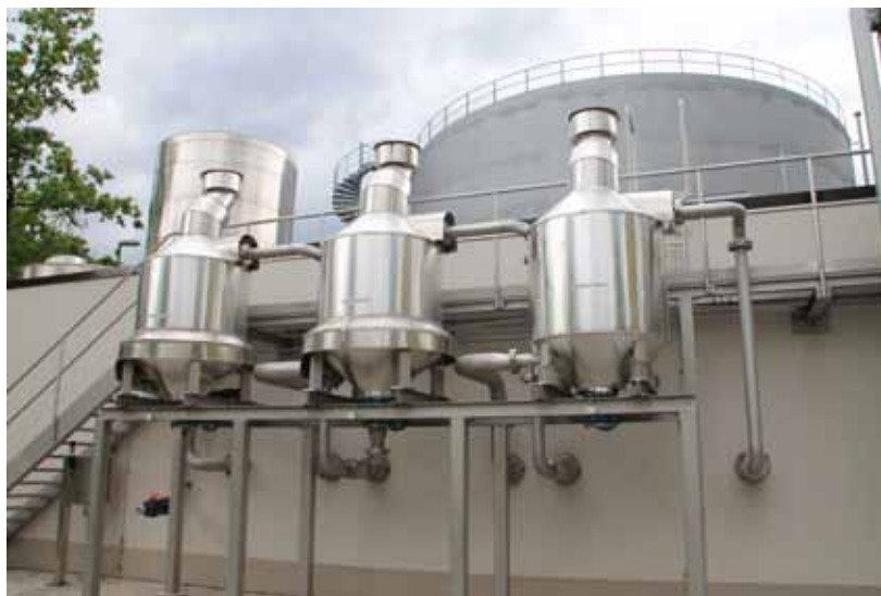
FIGURA 6.15 REMOCIÓN DE SILOXANOS POR CARBÓN ACTIVADO - PTAR DE AUGSBURG, ALEMANIA.
