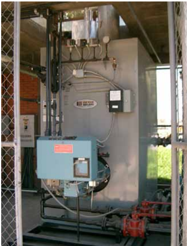
FIGURA 7.2 CALDERA DE TUBOS DE AGUA OPERADA CON BIOGÁS.
