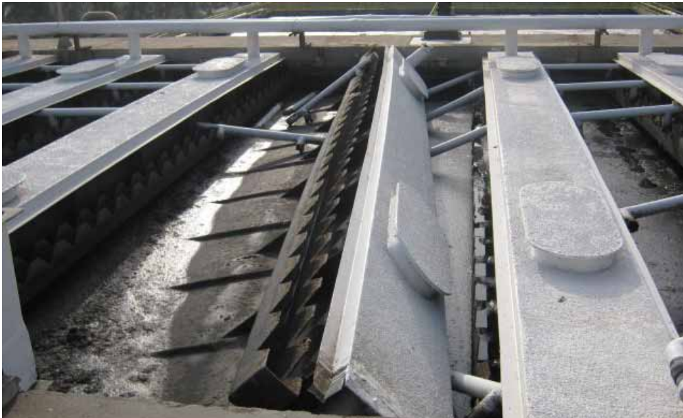
FIGURA 3.14 SEPARADOR TRIFÁSICO ROTO DEBIDO A LA OBSTRUCCIÓN DE LA TUBERÍA DE SALIDA DEL BIOGÁS CAUSADA POR LA ESPUMA.
