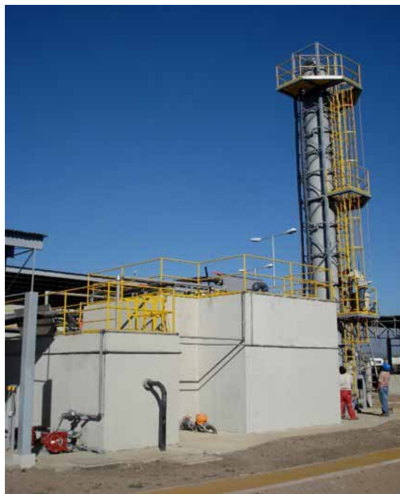
FIGURA 6.8 PROCESO MEXICANO PARA DESULFURIZACIÓN DE BIOGÁS, PLANTA CCU, SANTIAGO DE CHILE.
