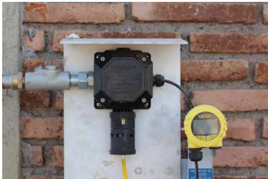
FIGURA 4.13 TRANSMISOR DE PRESIÓN EN UN GASÓMETRO DE DOBLE MEMBRANA.
