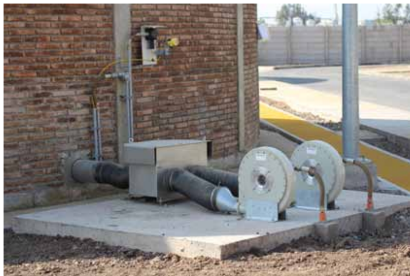
FIGURA 4.19 VENTILADORES AXIALES PARA SUMINISTRO DE AIRE A GASÓMETRO DE DOBLE MEMBRANA, INCLUIDA LA VÁLVULA DE RETENCIÓN.
