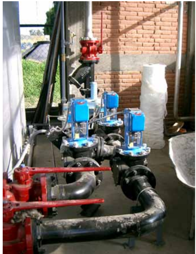
FIGURA 7.3 TREN DE GAS NATURAL Y TREN DE BIOGÁS EN CALDERA CON QUEMADORES DUALES.
