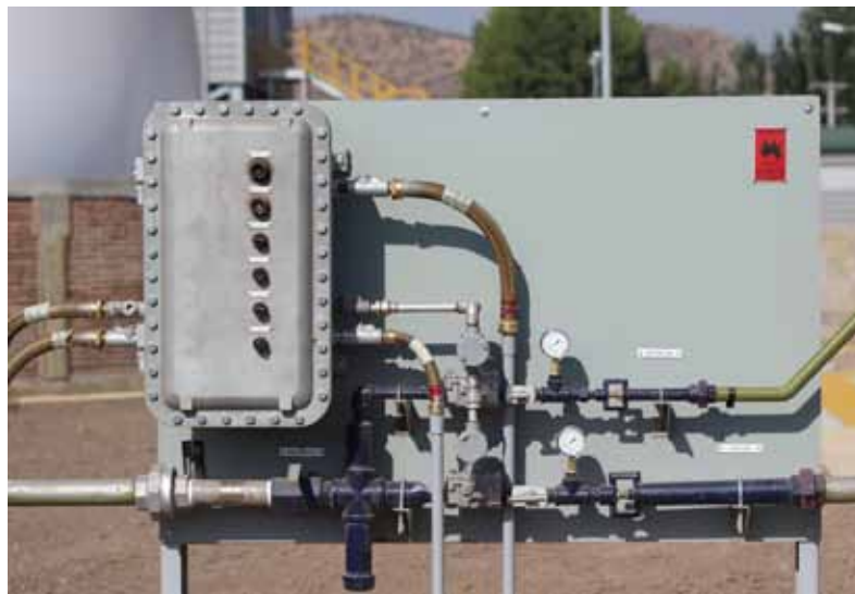
FIGURA 5.4 SISTEMA DE IGNICIÓN Y MONITOREO DE QUEMADOR (ARRIBA, IZQUIERDA) CON VENTURIS PARA REGULAR LA MEZCLA AIRE/GAS EN LÍNEA DE GAS PILOTO (ARRIBA) Y LÍNEA DE GAS PARA FRENTE DE FLAMA (ABAJO)
