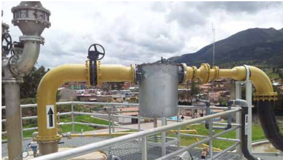
FIGURA 3.27 CAPTACIÓN DE GAS EN LA TAPA DEL DIGESTOR CON TRAMPA DE SEDIMENTOS Y HUMEDAD.
