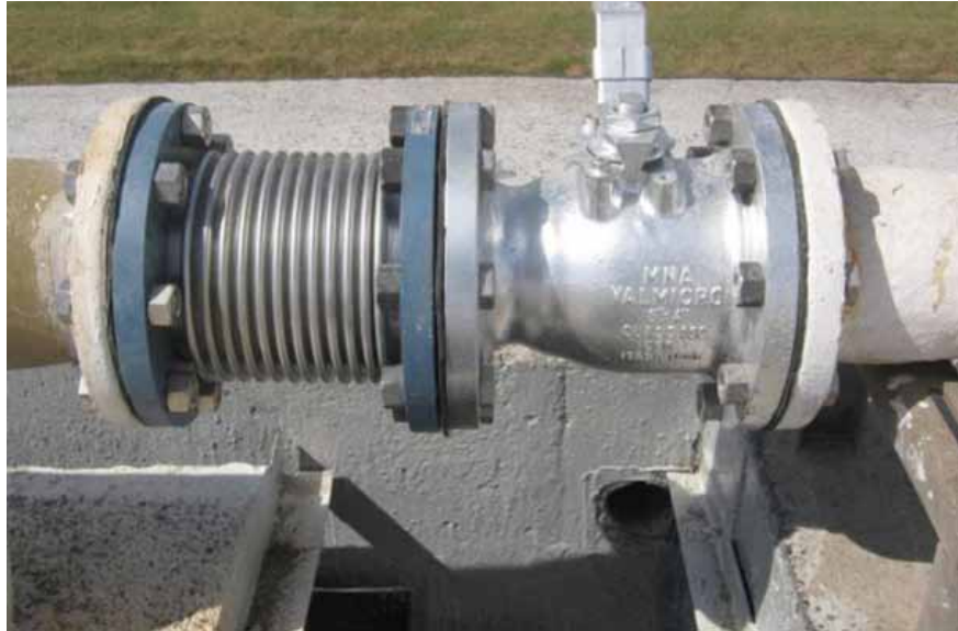
FIGURA 8.2 JUNTA DE EXPANSIÓN (IZQUIERDA) Y VÁLVULA DE BOLA PARA MANTENIMIENTO DE LA LÍNEA DE BIOGÁS.
