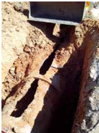
FIGURA 3.21 CANALETA SIN IMPERMEABILIZACIÓN, DESPUÉS DE CORROSIÓN.
