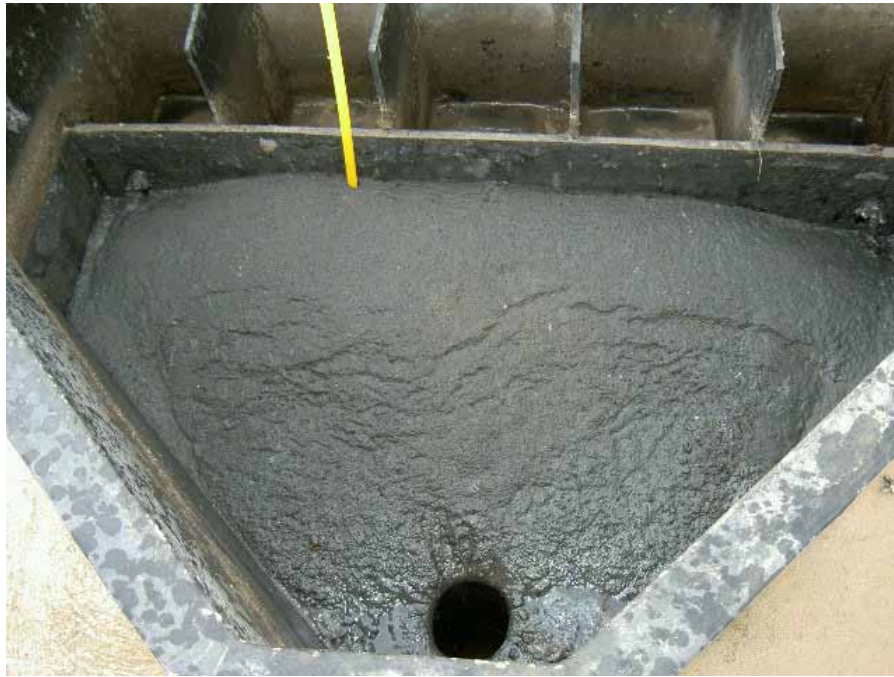
FIGURA 3.5 ACUMULACIÓN DE ARENA Y SÓLIDOS GRUESOS EN LA CAJA DE DISTRIBUCIÓN DE EFLUENTE DE LOS REACTORES UASB.
