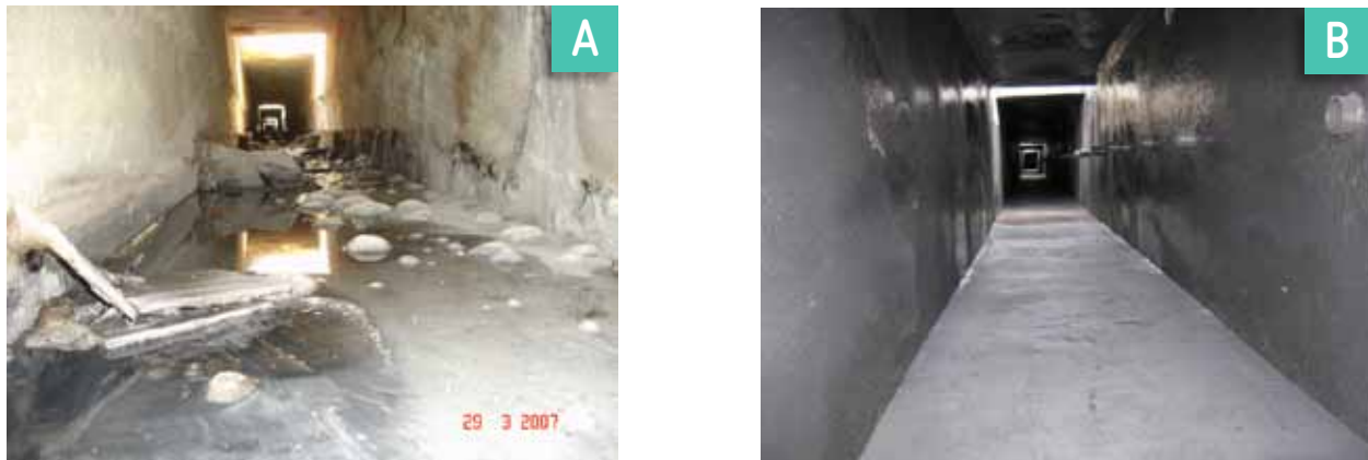
FIGURA 3.19 A) CANALETA DE CEMENTO SIN IMPERMEABILIZACIÓN, DESPUÉS DE CORROSIÓN. B) CANALETA DE CEMENTO RECUPERADA E IMPERMEABILIZADA.
