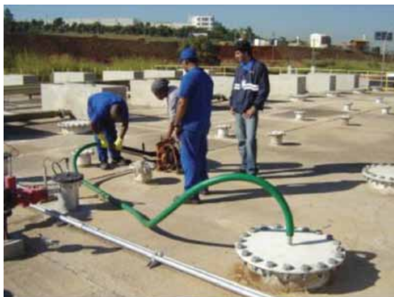
FIGURA 3.17 PROCEDIMIENTO DE VERIFICACIÓN DE LA HERMETICIDAD DEL REACTOR UASB A PARTIR DE LA INYECCIÓN DE AIRE.
