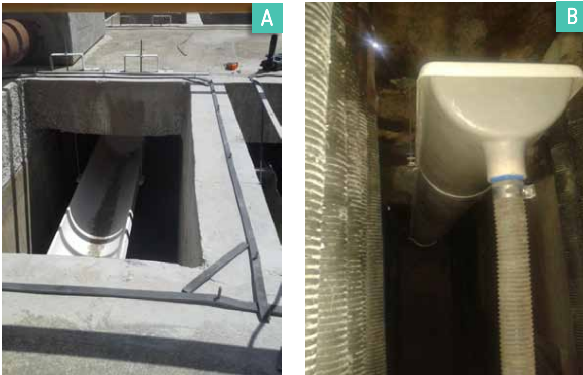
FIGURA 3.11 RAMPAS DE REMOCIÓN DE ESPUMA CON AJUSTE DE NIVEL INSTALADAS EN LA PTAR JACUÍPE II. VISTAS A) SUPERIOR Y B) INTERNA DEL REACTOR.
