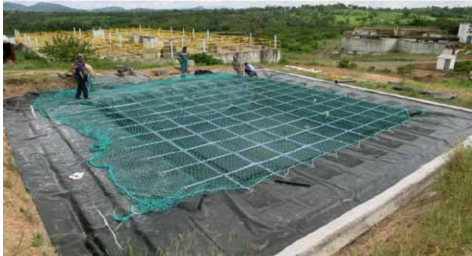
FIGURA 6.3 MONTAJE DE GASÓMETRO CON BIODESULFURACIÓN INCORPORADA – PTAR JACUÍPE II – BAHÍA.
