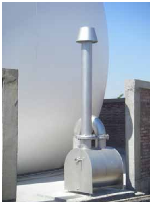
FIGURA 4.17 VÁLVULA DE ALIVIO (GUARDA HIDRÁULICA) EN UN GASÓMETRO DE DOBLE MEMBRANA.
