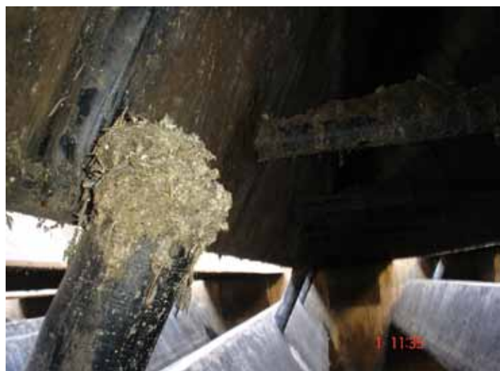
FIGURA 3.13 OBSTRUCCIÓN DE LA TUBERÍA DE RECOLECCIÓN DE BIOGÁS DEBIDO A LA PRESENCIA DE ESPUMA.
