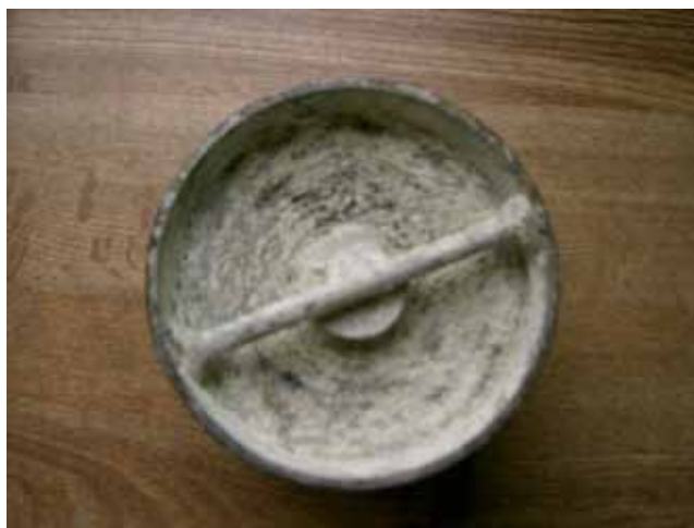
FIGURA 8.11 INTERIOR DE UN ARRESTAFLAMA HORIZONTAL TOTALMENTE OCLUIDO CON DEPÓSITOS DE SALES DE CALCIO.
