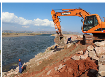
Links: Extremwetterereignisse können die öffentliche Infrastruktur schädigen und zur Sperrung wichtiger Verkehrsachsen führen.
