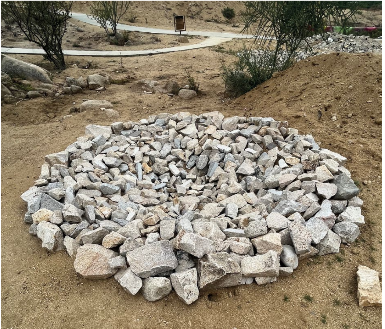
Pozo de absorción. ©Alianza Oasis Urbanos.
