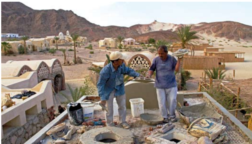
© M. Seyppel. Deux ouvriers construisent une maison énergétiquement performante et respectueuse du climat.
