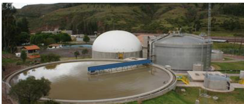
Producción de biogás en la planta de tratamiento de aguas residuales en Cusco.
