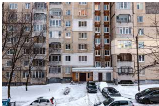
Vor der Sanierung: Die Fassade eines Wohngebäudes in Lwiw, Bezirk Sychiv, der zum energieeffizienten Stadtteil werden soll. Durch die ungenügende Dämmung geht viel Energie verloren.
