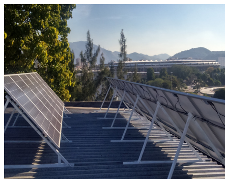
Links: Photovoltaikanlage auf einem Carport auf dem Campus der Bundesuniversität von Rio de Janeiro
