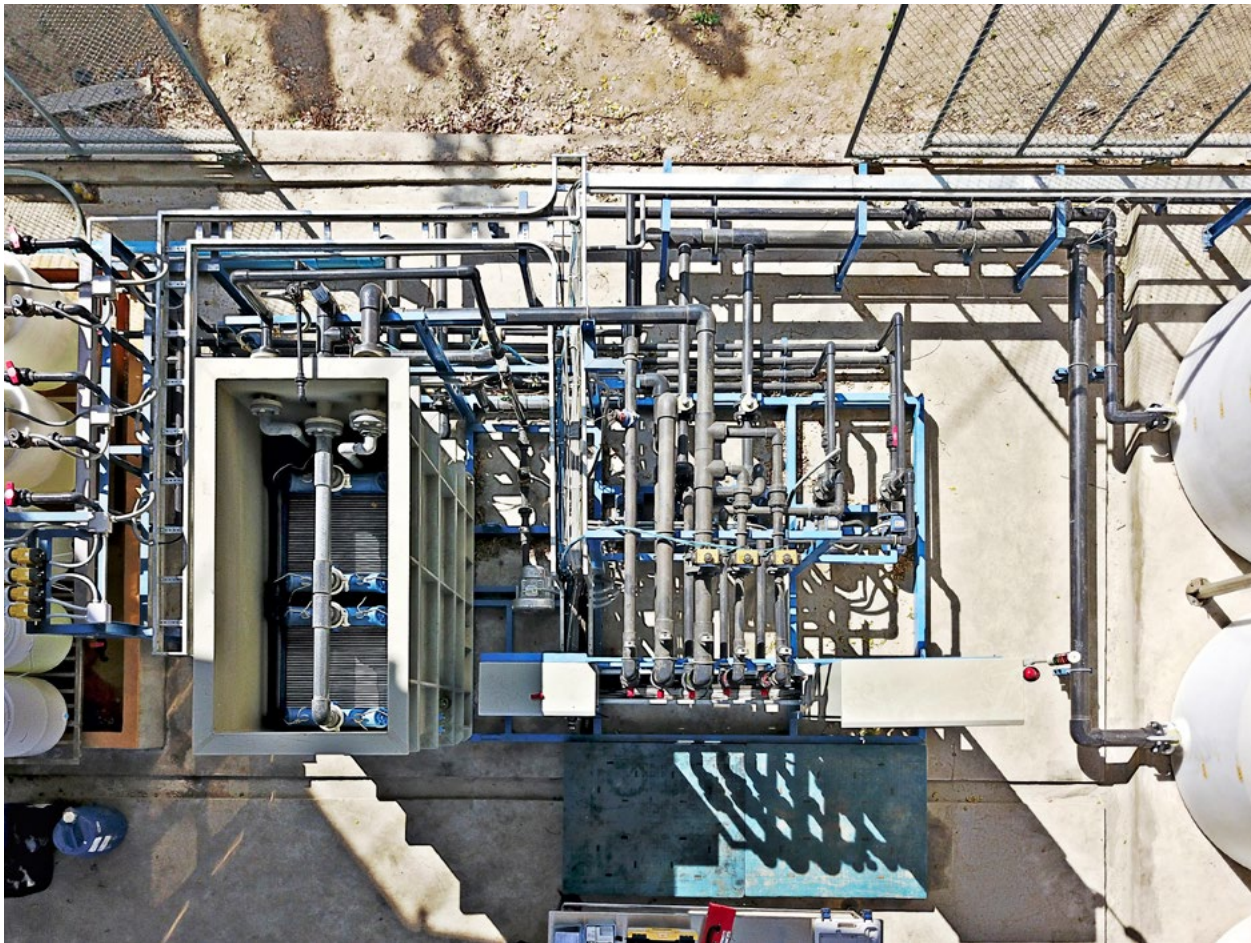
شكل ٢: صورة فوتوغرافية لمحطة Cerafiltec المدمجة
