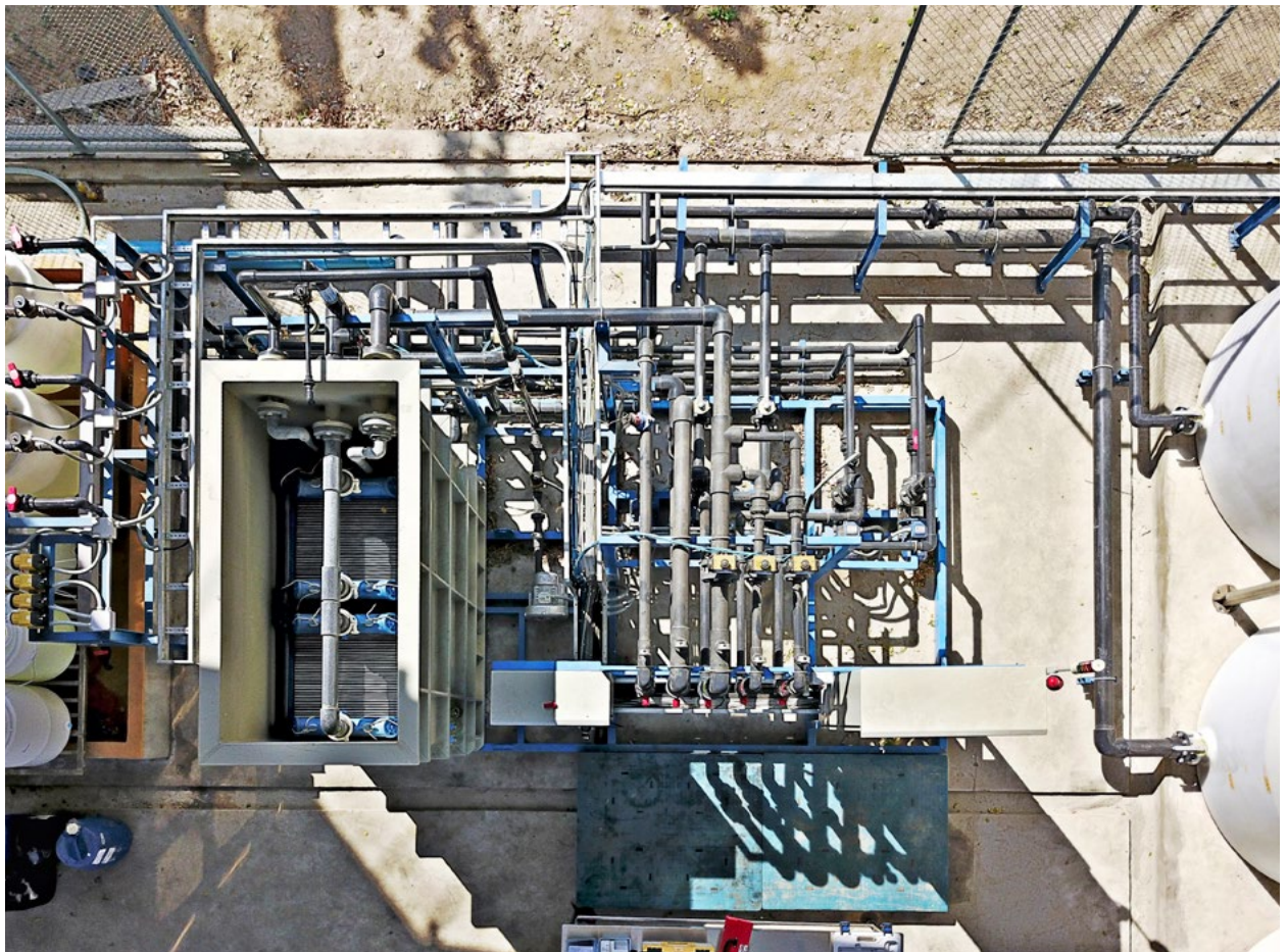
Abbildung 2: Fotografie der eingebundenen Cerafiltec-Anlage
