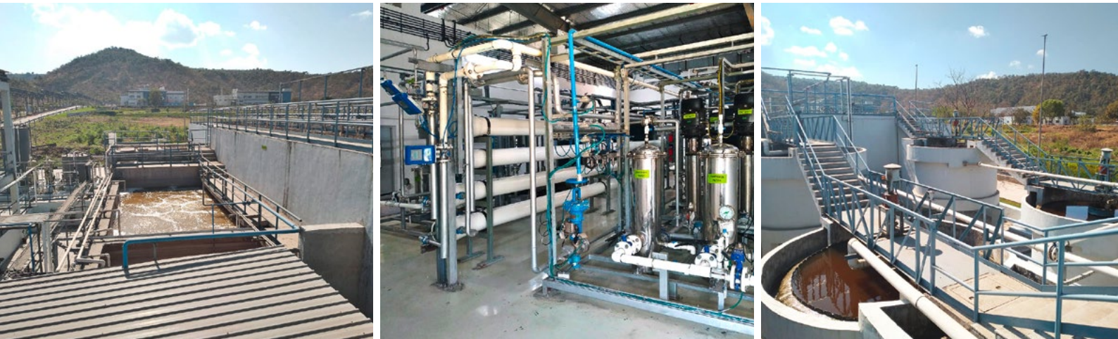
Abbildung 2: 8.3 m 3 /h SUFRO®-Anlage bei Mumbai, Indien – Biologische Reinigung (links), Umkehrosmose (mitte), Nachklärbecken und Ultrafiltrationstank (rechts)
