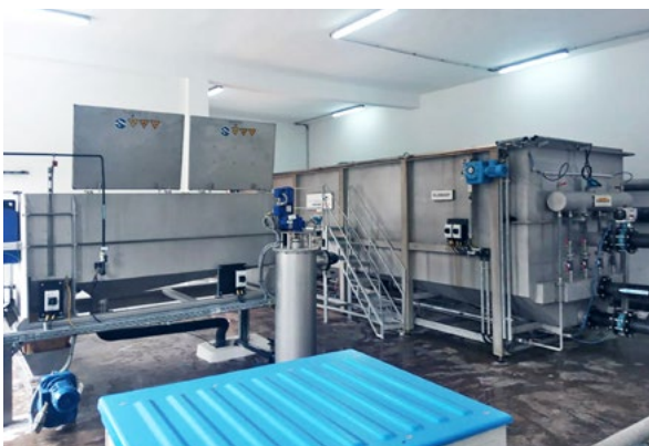
Abbildung 1: Platzsparend installiert – Flomar® Flotation zur Abwasservorbehandlung und Schnecken- presse zur Schlamm- entwässerung in einer Fischfabrik in Marokko
