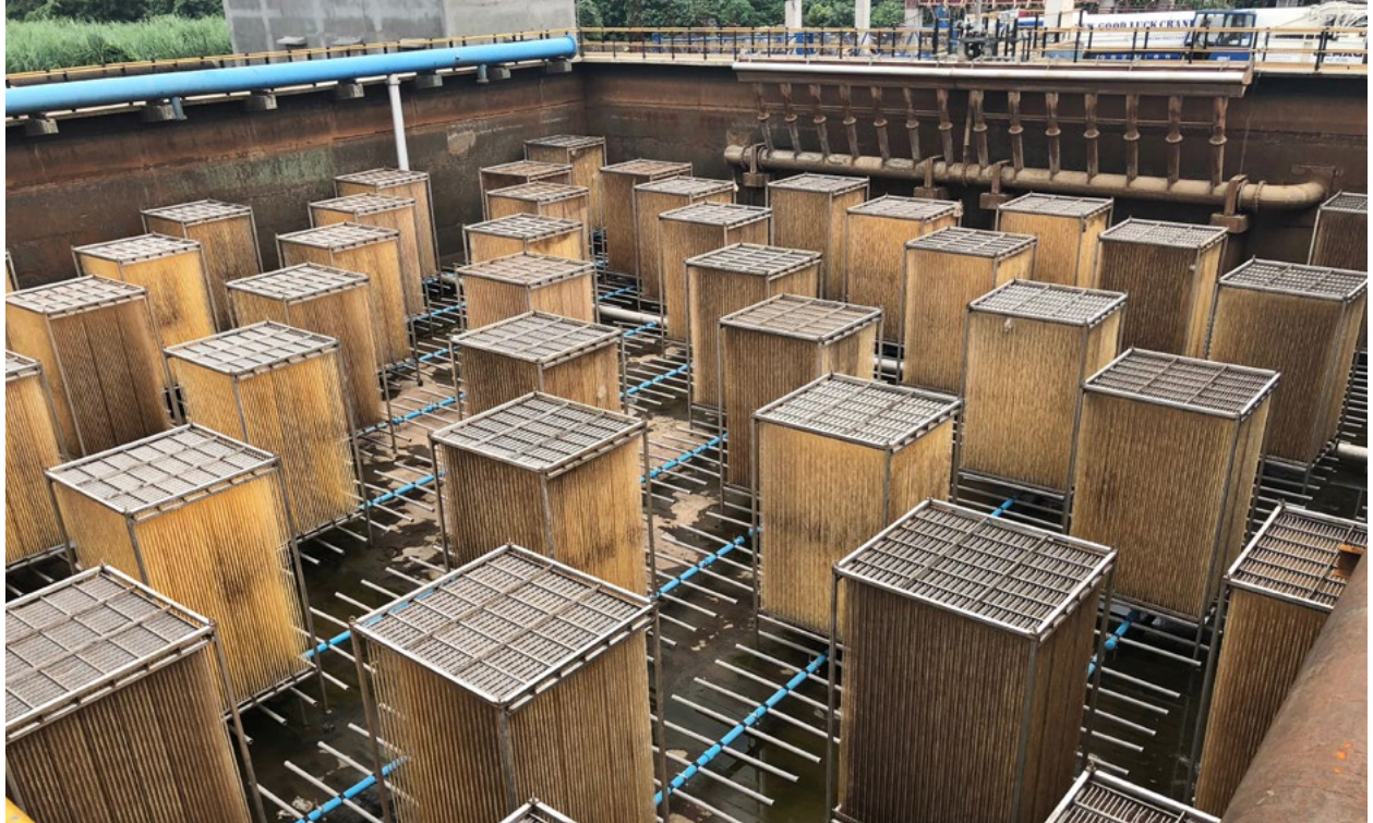
Abbildung 1: Eines von sechs SBR-Becken mit Biocurlz-Käfigen und feinblasigen Rohrbelüftern
